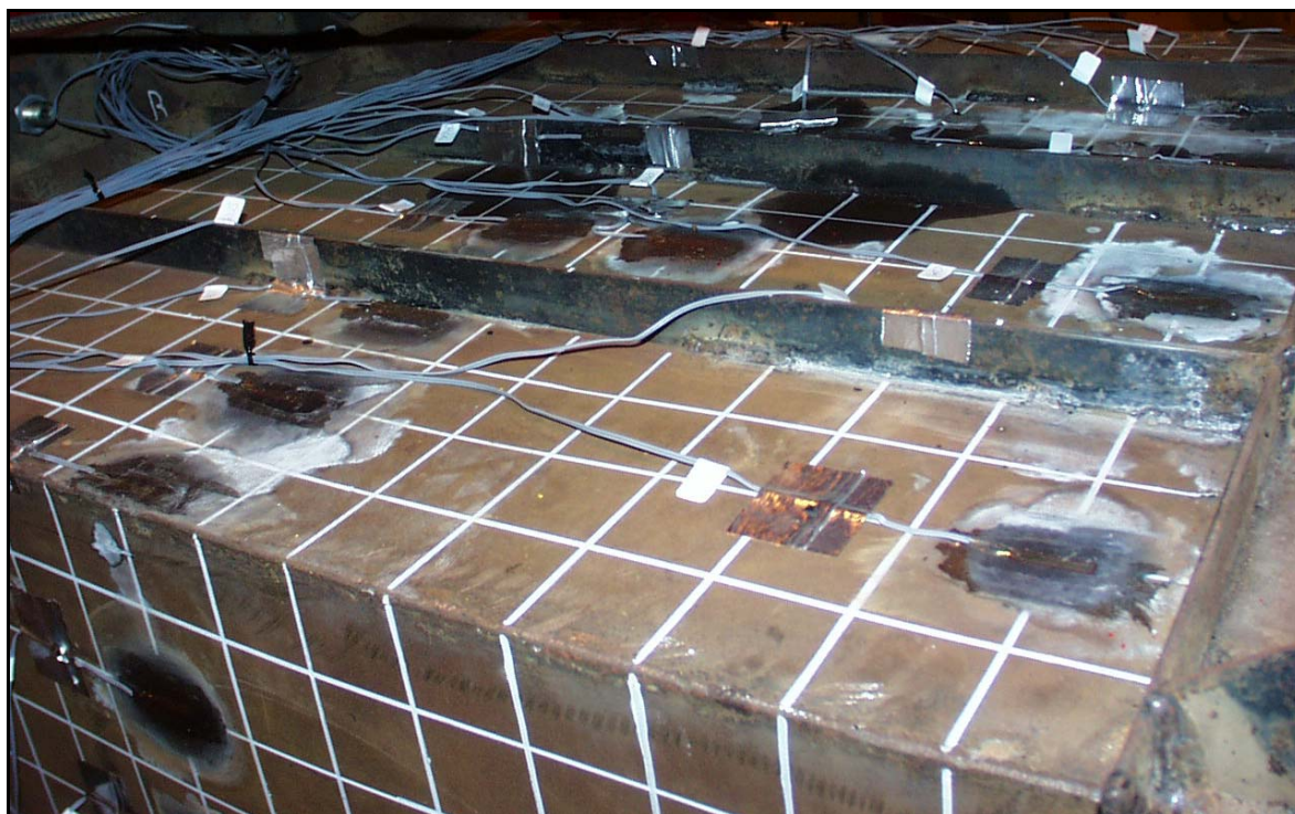
Figura 256 Vista do painel em compressão
