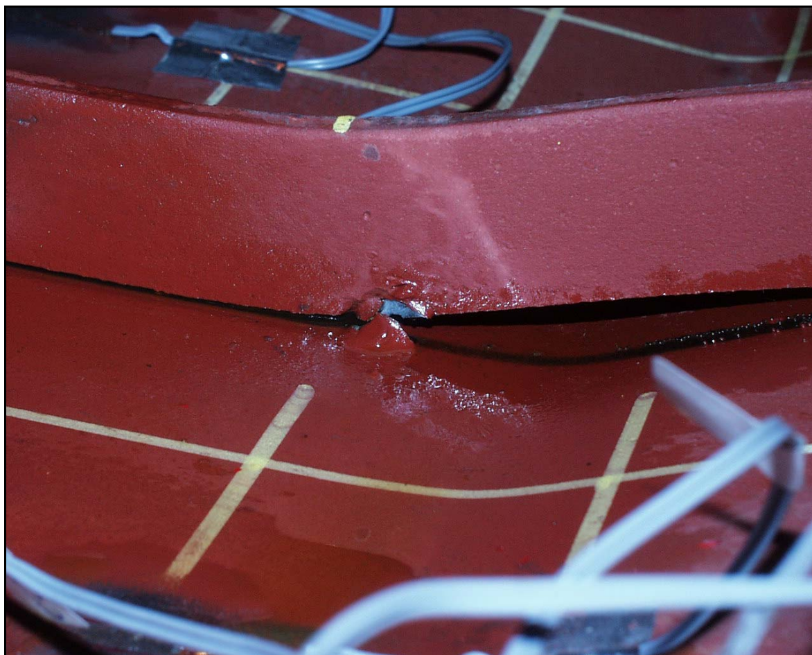
Figura 236 Falha na soldadura de ligação placa-reforço e pormenor das grandes deformações verticais permanentes no reforço devido à geometria da falha da placa.
