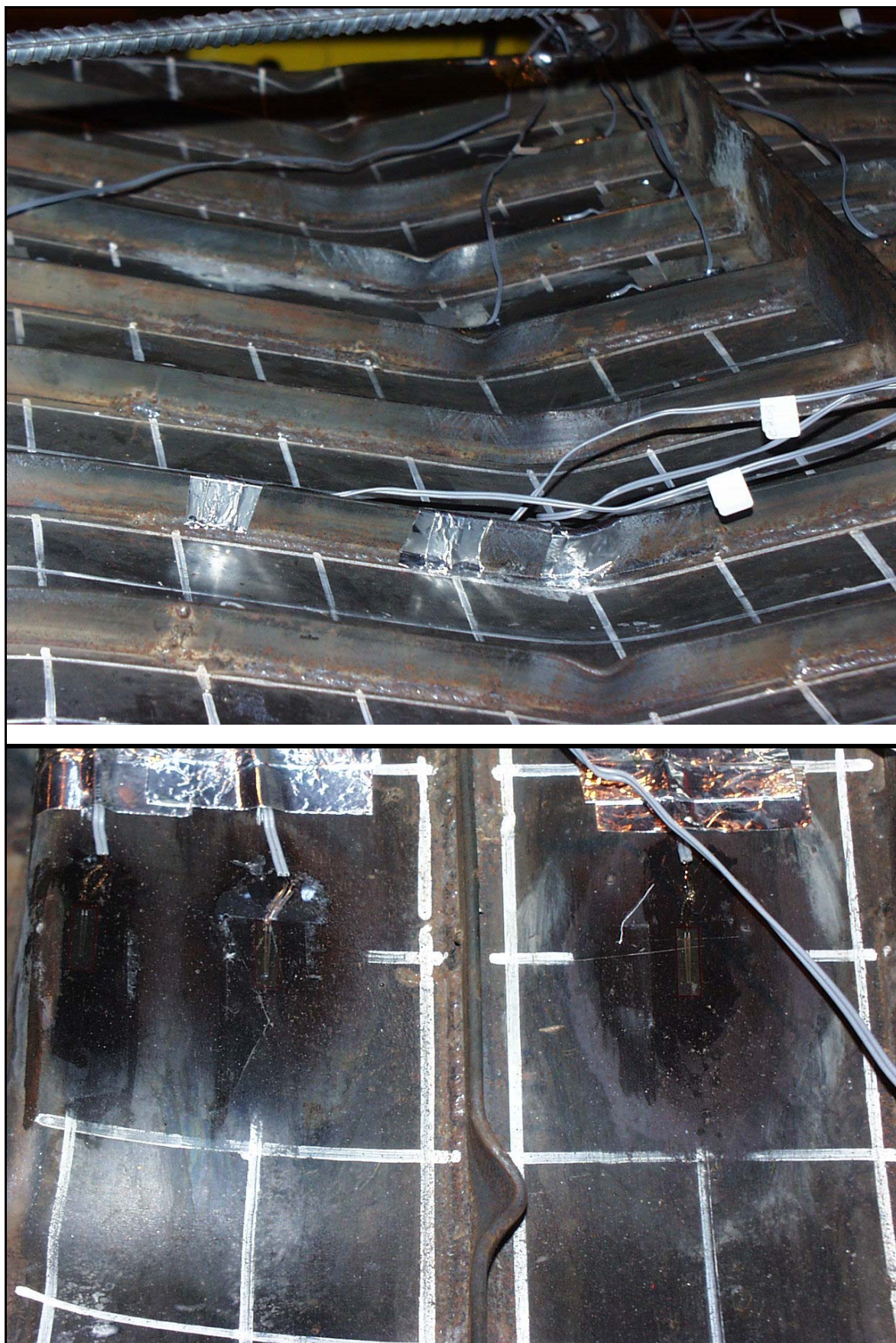
Figura 264 Pormenores da falha do reforço. Não é detectável qualquer tipo de instabilidade dos elementos de placa.
