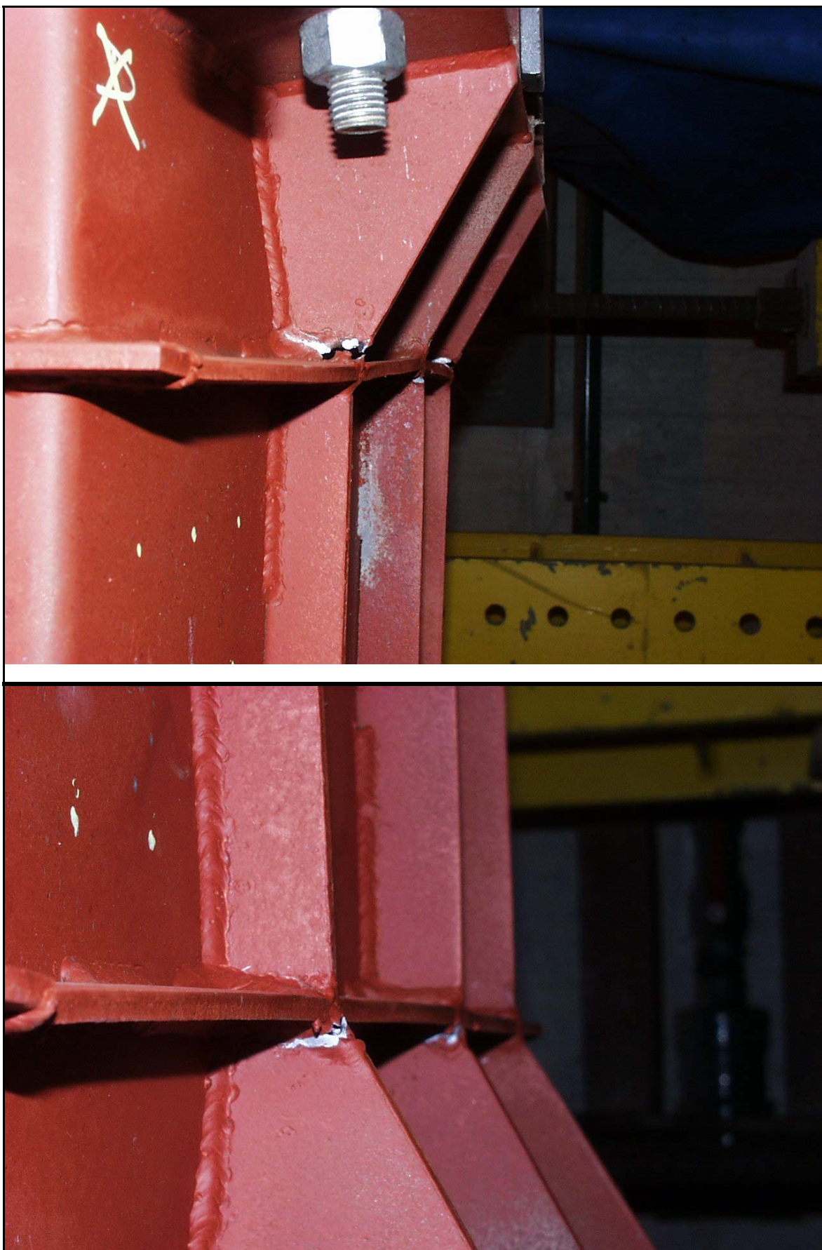
Figura 235 Pormenores das falhas nas soldaduras do esquadros do painel em tracção devido às grandes deformações na fase de pós colapso.
