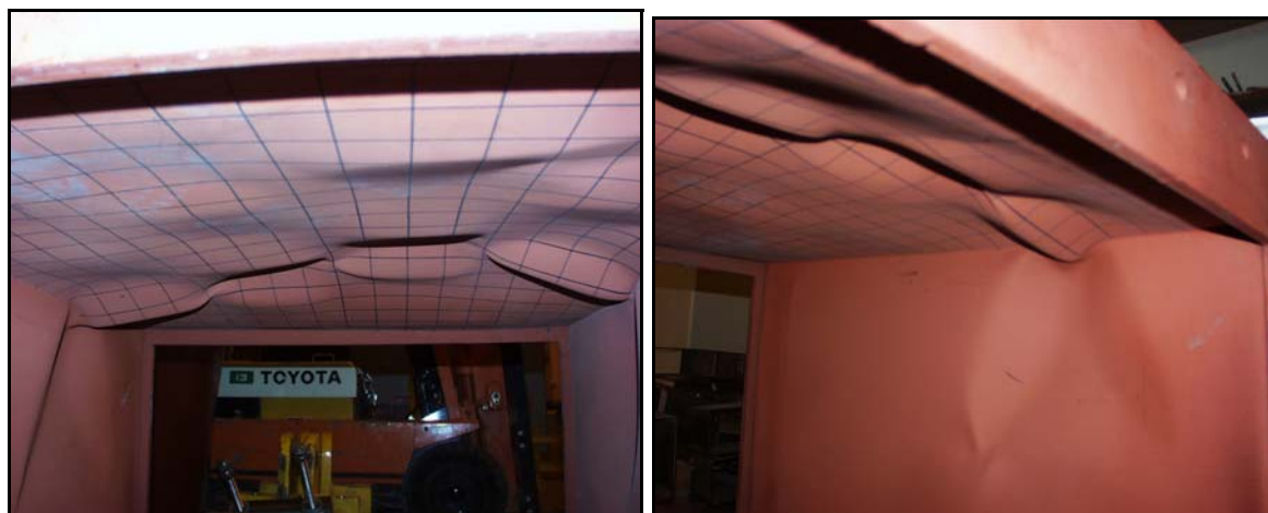
Figura 244 Deformada final da placa em compressão
