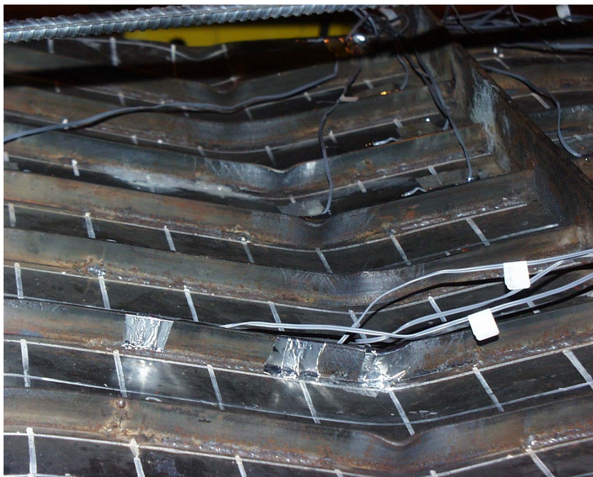
Figura 207 Pormenor da falha por instabilidade do reforço do modelo M3-100
