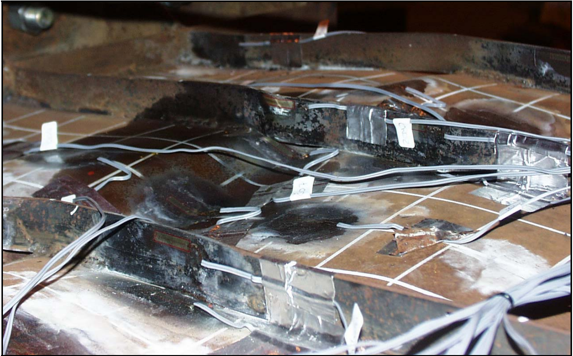
Figura 260 Pormenor da falha do reforço após a falha da placa. Importância da soldadura contínua na resistência pós colapso.
