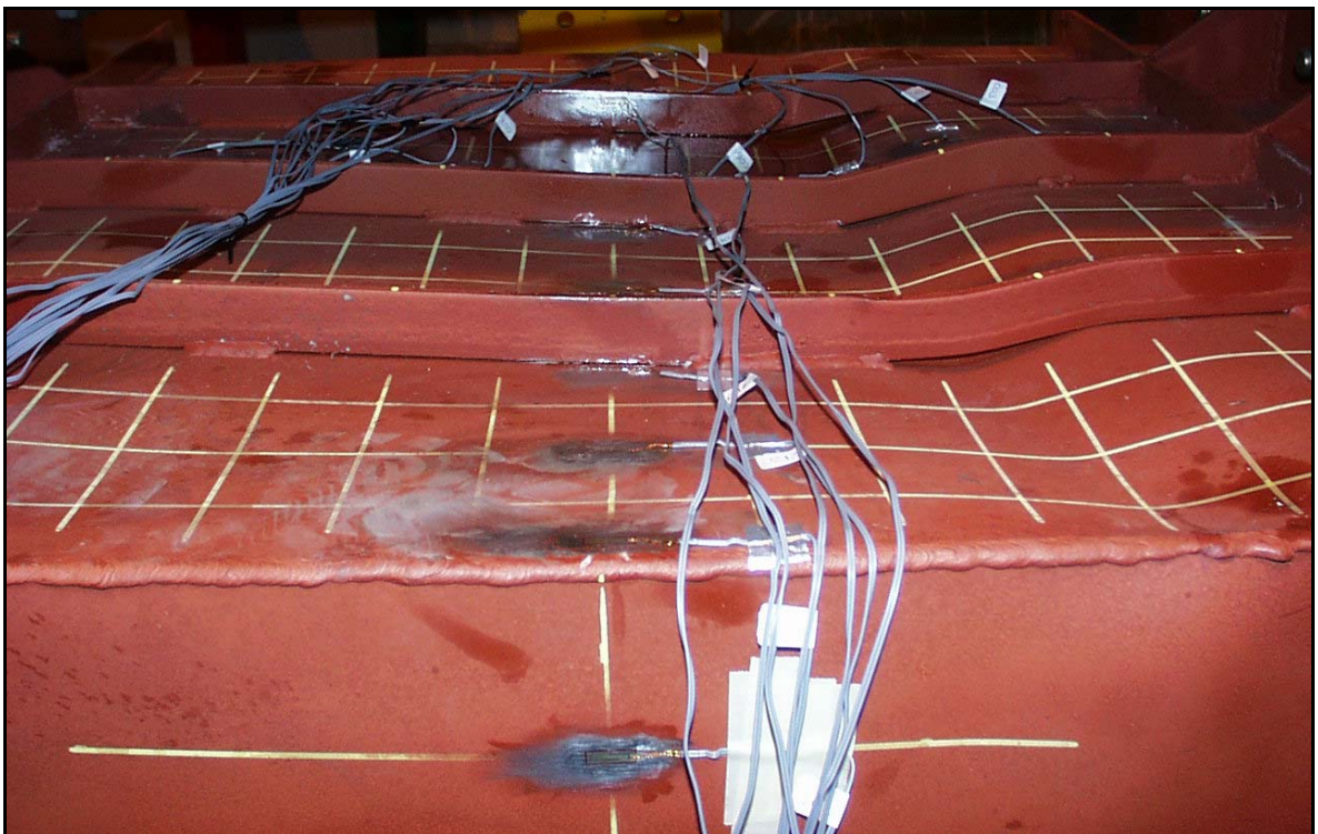
Figura 233 Deformada residual do painel em compressão após o colapso da estrutura. Falha da placa muito localizada acompanhada por deformações importantes na barra dos reforços.
